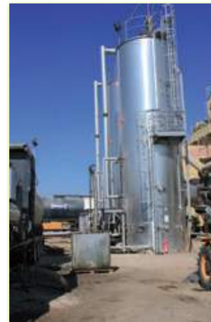
Figure 20. Réservoirs auxiliaires de stockage
