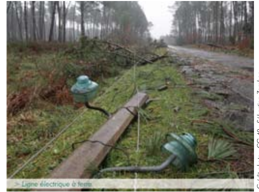
> Ligne électrique à terre
